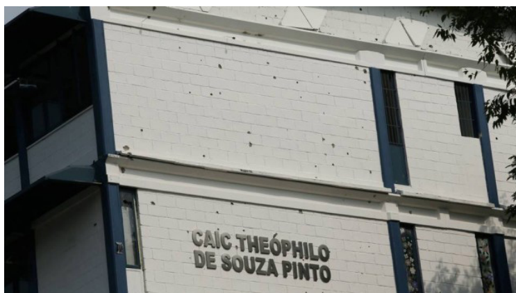
Imagem 5. Fachada do CAIC Theóphilo de Souza Pinto, perfurada por projeteis em decorrência dos confrontos armados
